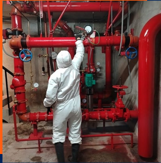
Instalación y Mantenimiento Integral de Sistemas Contra Incendios
