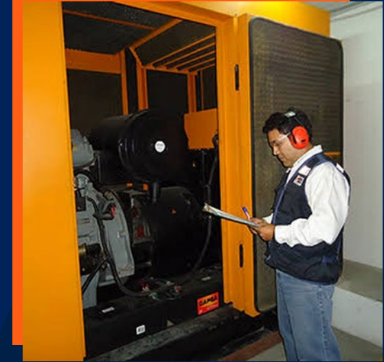
Servicio de mantenimiento y alquiler de grupo electrógeno
